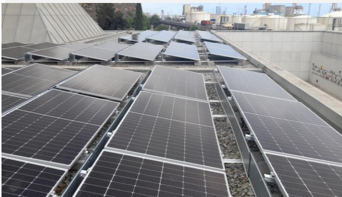
Plaques fotovoltaïques instal·lades al Crematori de Montjuïc.
