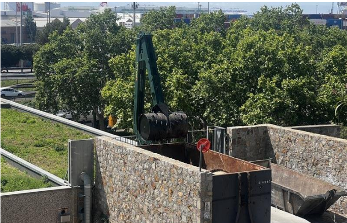
Compactadora del Cementiri de Montjuïc.
